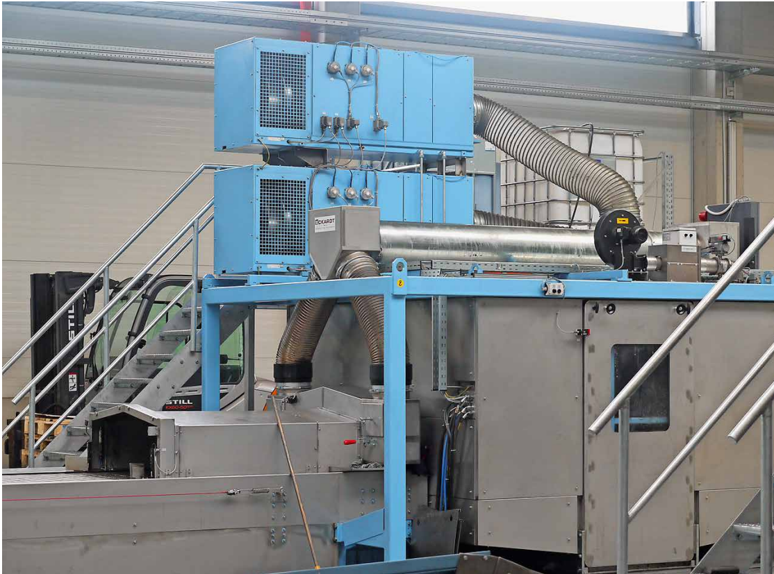
Seitenansicht der Anlage mit dem oben zu erkennenden Filtersystem.
